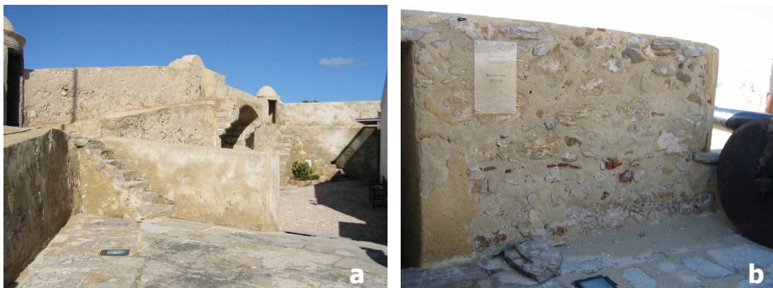
Fig. 10 – Forte dos Oitavos (Cascais). a) e b): Degradação elevada do revestimento: erosão, perda de coesão, manchas de humidade, eflorescências e criptoflorescências
